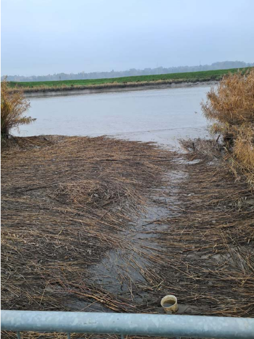
Abb. 2: Zulaufsituation am Siel Achthöfener Fleth (Dezember 2020)
